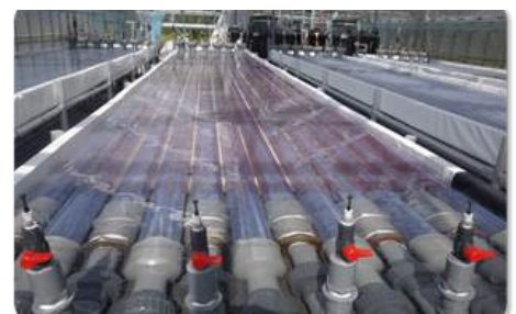
【デモプラント内】
